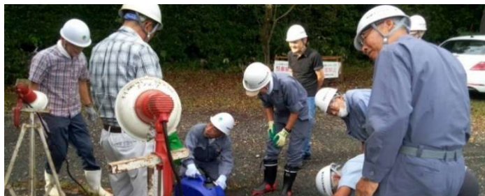
ポンプ点検 9月日(日) 於：各防災倉庫前
